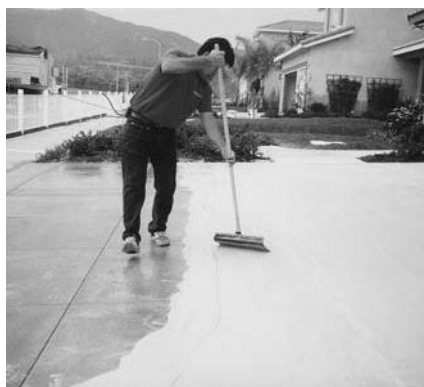
Continúe esparciendo el material delante de la persona cepillando utilizando el jalador metálico.
