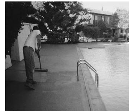
Aplique dos capas de Colorcoat 100 usando rodillo de 3/4" Opción: Aplique Sealcoat 1000 transparente.
