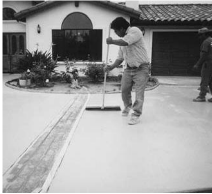
Aplique un acabado Fine Broom Finish o de Swirl Pattern Finish sobre la capa seca de Squeegee/Bond Coat.
