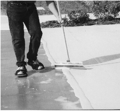
Aplique una capa adhesiva con jalador de Ultra Surface Polymer Concrete sobre la superficie.
